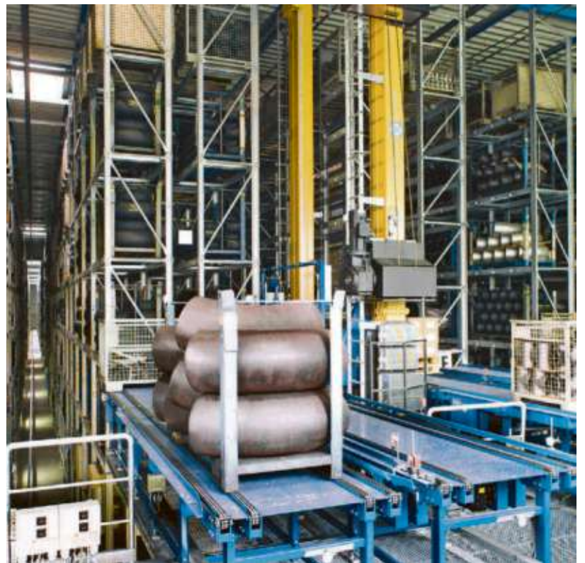
Hochregallager mit über 10.000 Stellplätzen.
